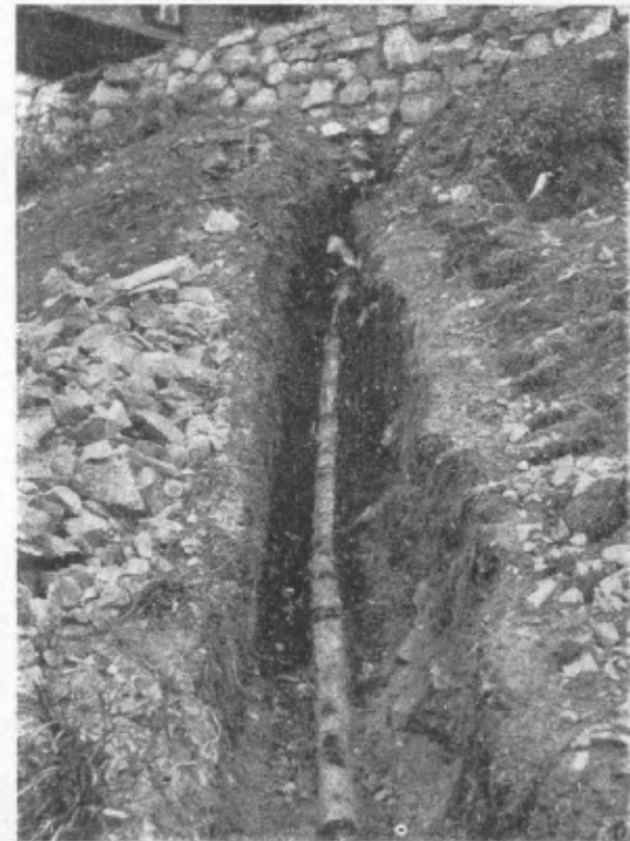
Bild 3. Das alte Rohr.
